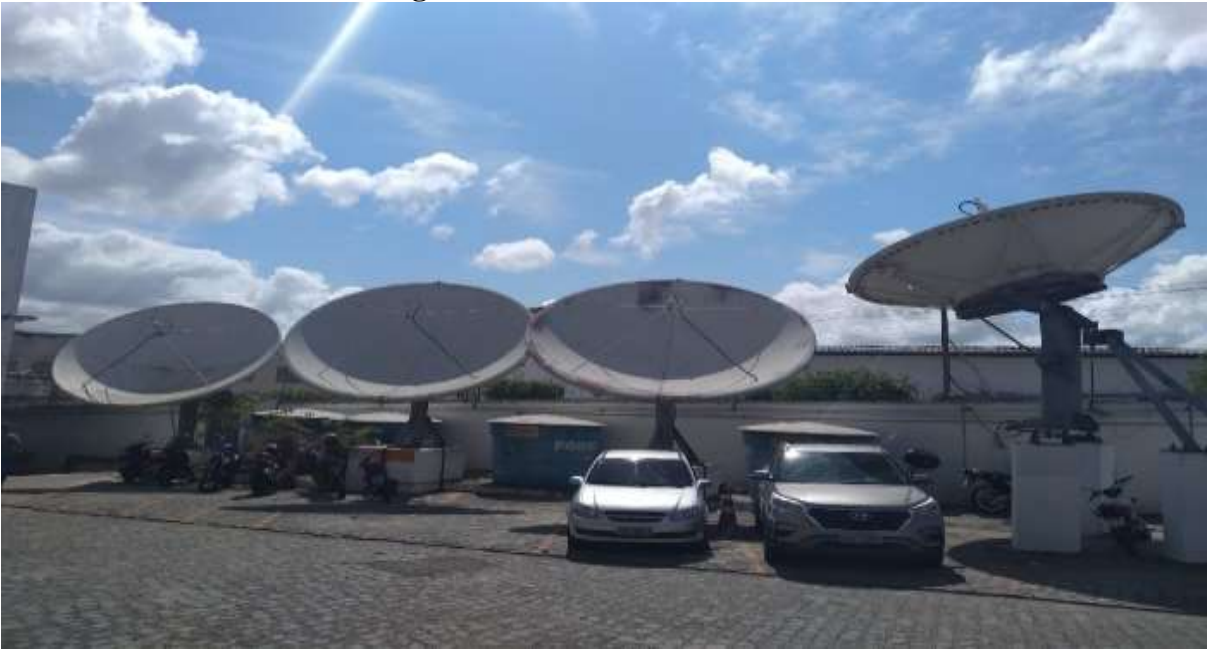
Figura 11 – Antena de subida de satélite
